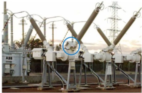
Outdoor MTS with redundant EIT & IEC 61850-9-2 (LE) process bus
